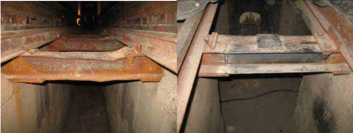
Zdeformovaná a opravená raverza
