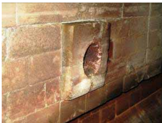
Príklad prasknutého a vysunutého horákového bloku
