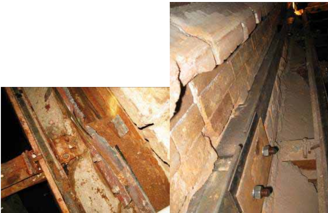
Zdeformovaný a opravený pieskový tesniaci žľab
